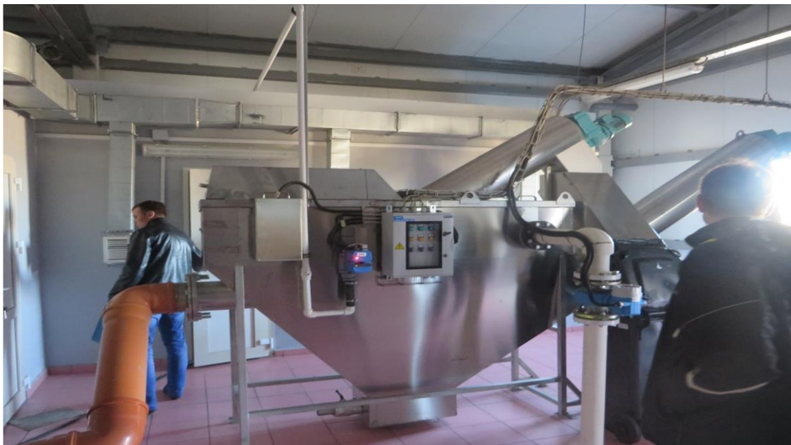
Рисунок 15. Устройство грубой предочистки
