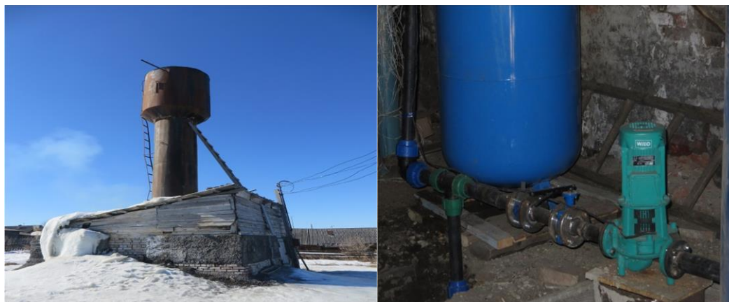
Рисунок 10. Скважина централизованного водоснабжения с.Кишкинское
